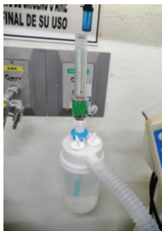
Figura 46. Humidificador con manguera corrugada.
